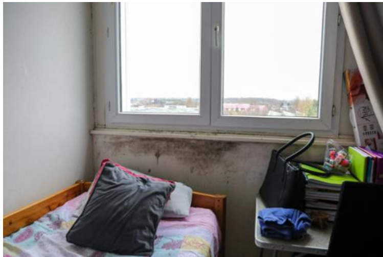
Un logement insalubre dans le quartier des Trois-Ponts, à Roubaix (Nord), en février 2023. THIERRY THOREL/PHOTOPQR/« LA VOIX DU NORD »/MAXPPP
